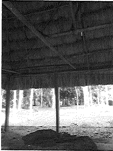
Fig.2: Techo de guano deteriorado.
